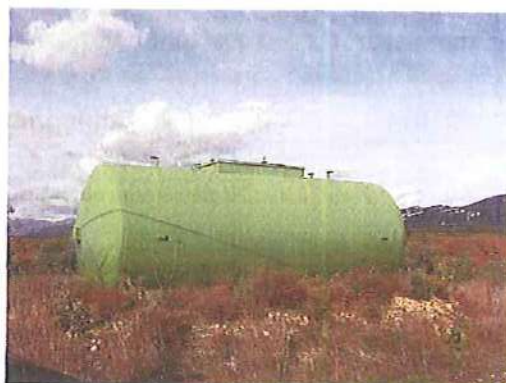
La citerne de la Gardiole (Conqueyrac) est dépourvue de signalisation
